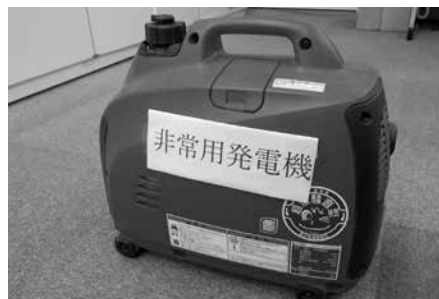
非常用電源の一例
